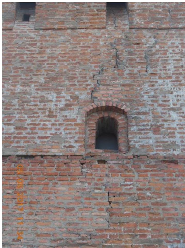
Рис. 19. Северный фасад Покровской башни. Вертикальные трещины.
